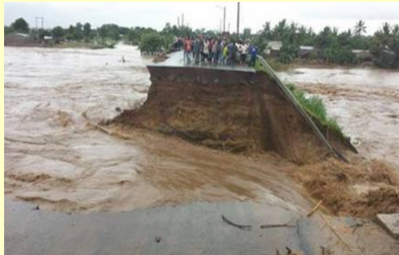
Eine andere wichtige Brücke ist ebenfalls zerstört.
